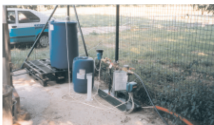
Zdj. 1. Neutralizacja odorów w sieciach kanalizacyjnych. Dozowanie do ścieków, INHITONE P1
