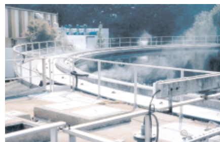
Rys. nr 2. Bariera antyodorowa nad osadnikiem ściekowym, AIRHITONE A4S2
